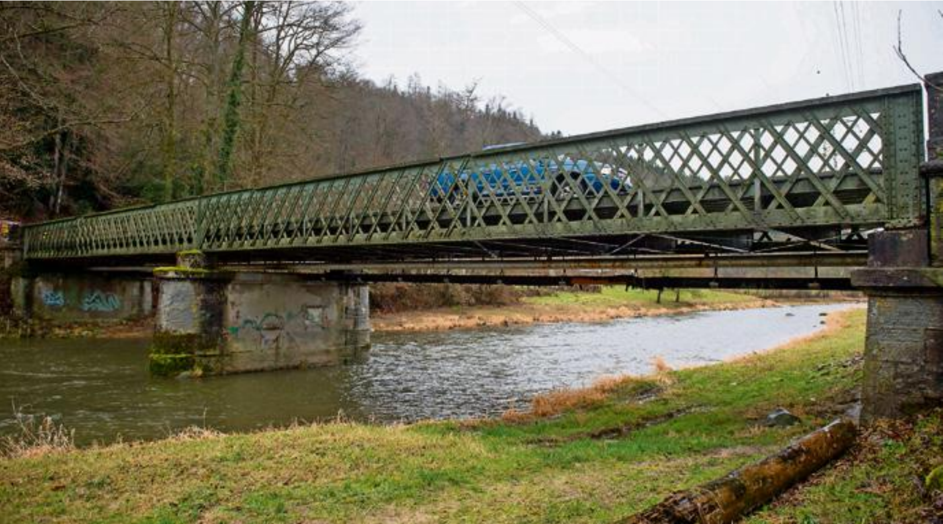
Der Zahn der Zeit hat an der 130-jährigen Fachwerkbrücke bei Sihlwald genagt. Die Sanierung, zu der die Gemeinde Horgen verknurrt wurde, kostet rund 1,8 Millionen Franken.
